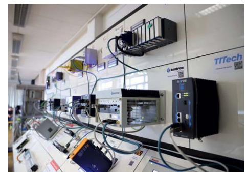
Der TSN-Demonstrator des 'IIC TSN Testbed' am ISW. Gerade Testbeds spielen bei dem Einstieg in die TSN-Technologie eine wichtige unterstützende Rolle.
