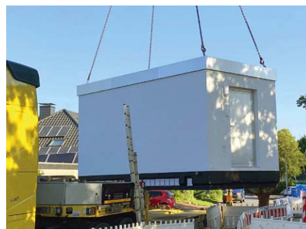
Schlüsselfertige Point-of-Presence-Zellen liefert R&M Deutschland per Tieflader an den Einsatzort.
